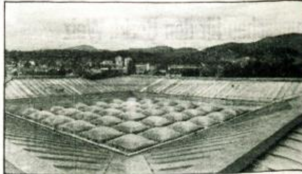
Selbst nach drei Jahren Arbeit wurde das Dach nicht dicht gemacht.
